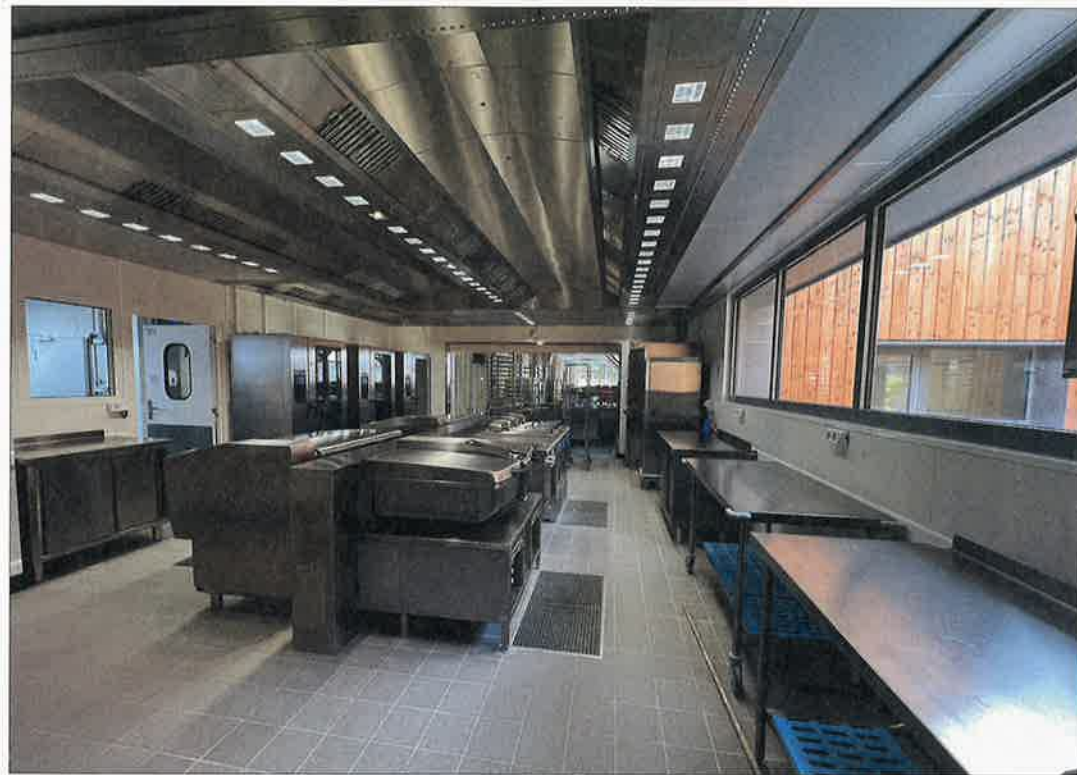
La cuisine du lycée d'enseignement général et technique d'Aizenay (85), opération livrée en 2022 par l'agence CRR Architecture, prépare actuellement 620 repas/jour mais a été dimensionnée pour en délivrer 830.
